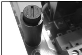
Figur 6: Sikringsskift ved Swing
